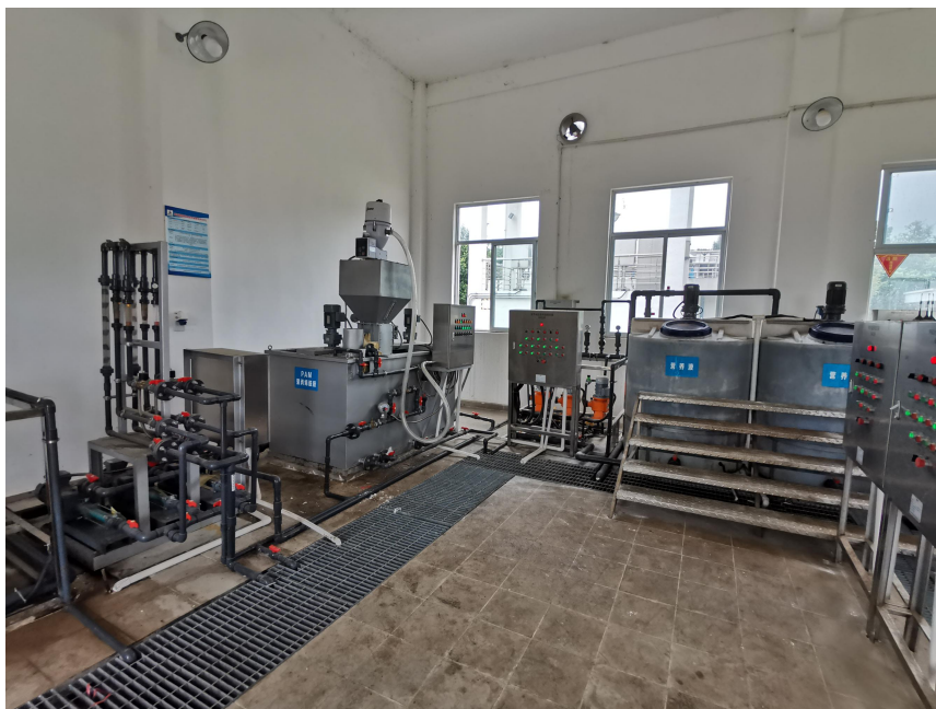
图 3.1-6 加药间地坪现状
